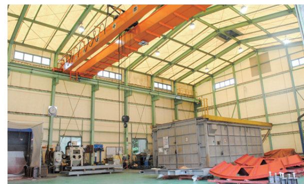
塗装の建屋に増設されたクレーン
