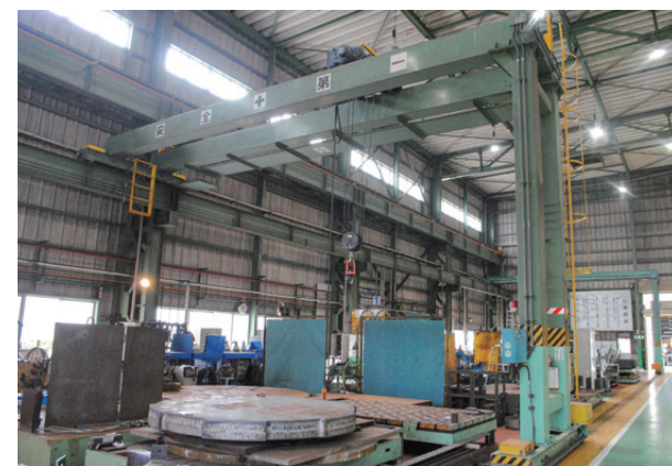
製作・溶接の建屋に増設されたクレーン
