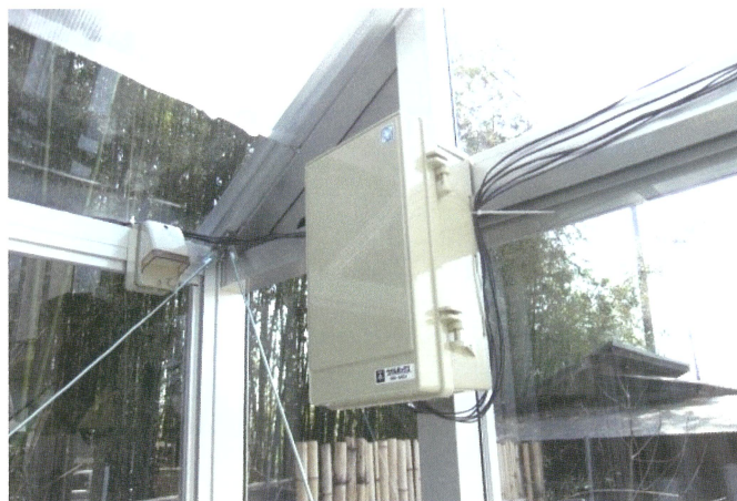
▲恒温制御システム
