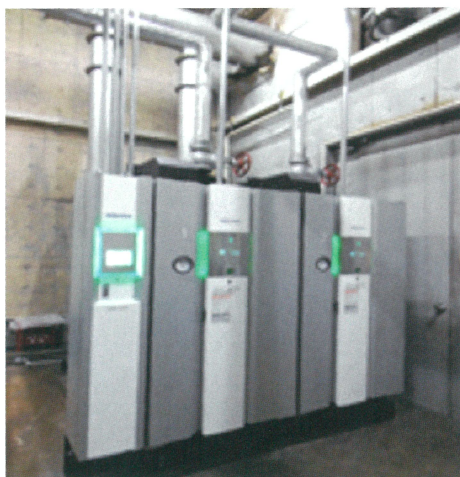
新型ボイラー
