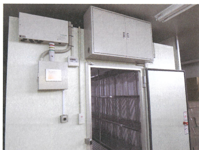
新規設置した高圧静電場冷蔵庫
