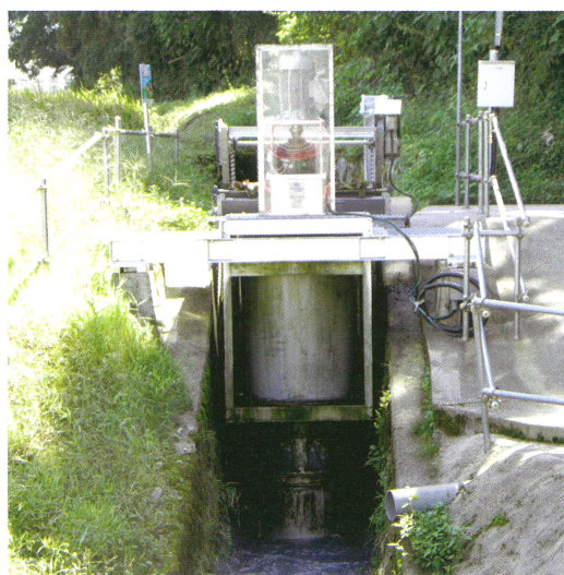
小水力発電システムの設置例
