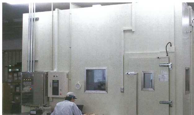
冷凍サイクル実験室
