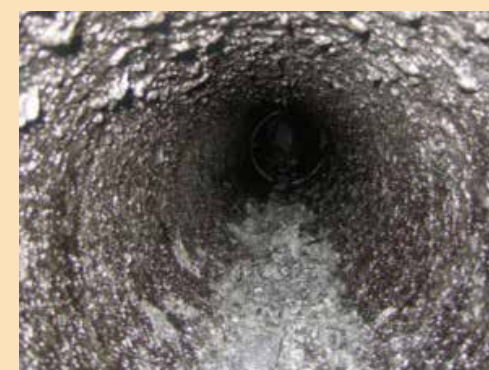
汚れが付着したダクト内部
