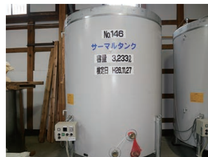
導入したサーマルタンク
