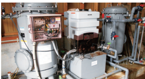
地下水汲み上げ装置、除鉄・除マンガン装置
