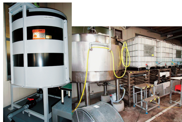
試作用洗浄剤調合実験用機械の「攪拌機付きタンク」と、基本洗浄剤調合設備
