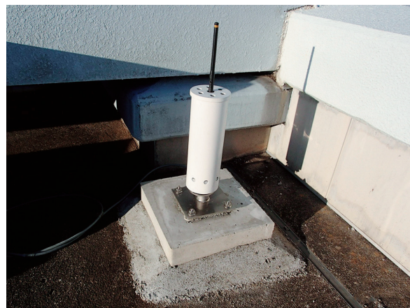
ビルの屋上などに設置。パソコンで遠隔操作できるので、頻繁に現場でチェックする必要はない
