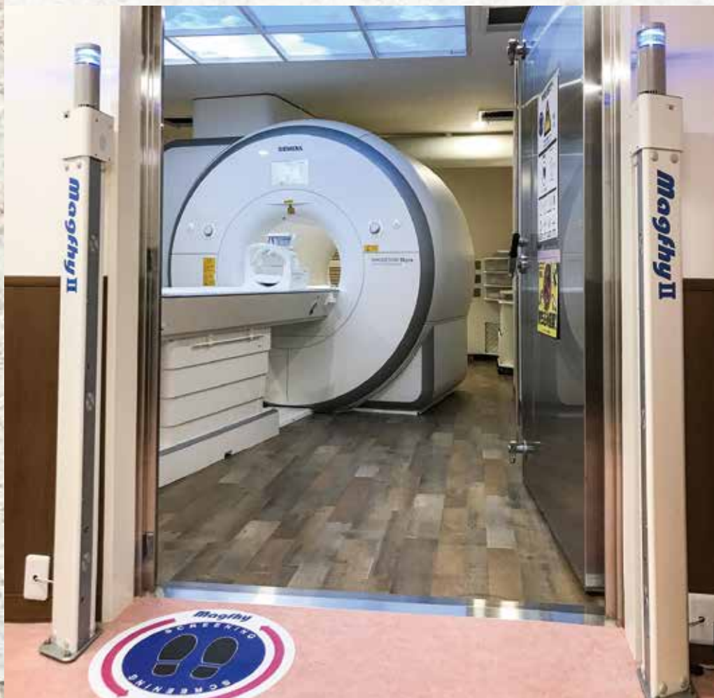
ベクトル検知方式を採用した「マグフィーⅡ」の設置事例
