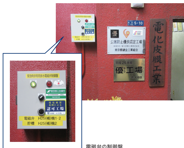
電磁弁の制御盤
