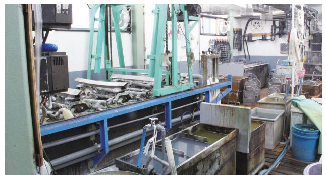
システム構築後の工場内全景
