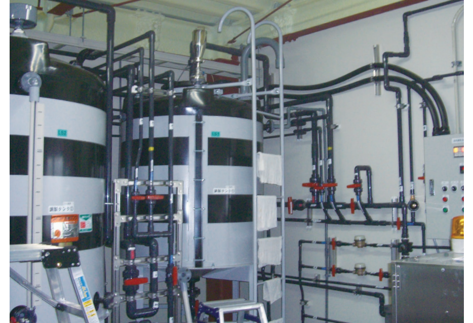
導入された溶液自動製造設備
