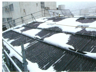
地下水の二次利用として屋根に散水し融雪への活用を促す
