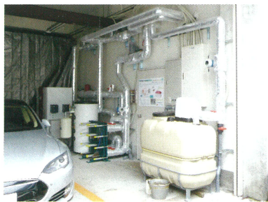
システムの実証試験で導入された地中熱ヒートポンプ
