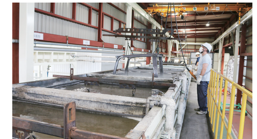
2017年に導入した表面処理設備
