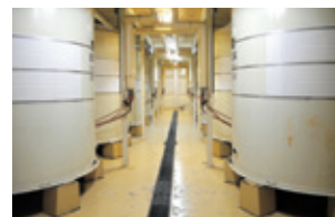
富士見蔵の貯蔵タンク
