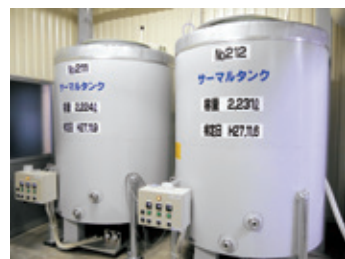
サーマルタンク
