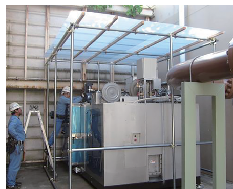
図1. 試作装置を設置している様子
