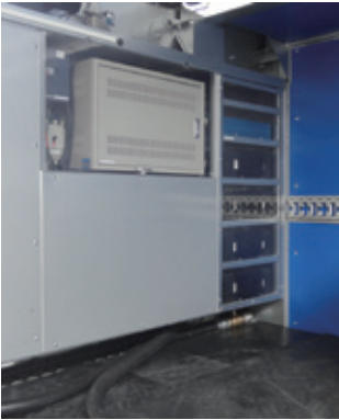
蓄電システム装置
