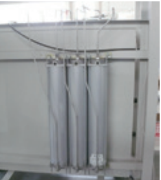
水素ガス分離タンクユニット
