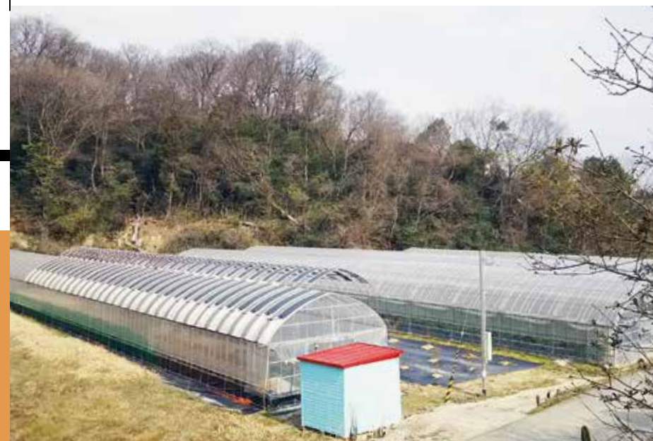
農業ハウスに設置した太陽光発電システム
