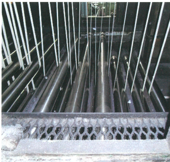
POINT1：ベーキング機内部
