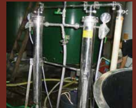
【仕込水をろ過するSFフィルター】
