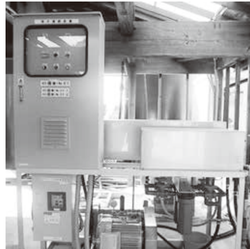
逆浸透膜3号機の外観
