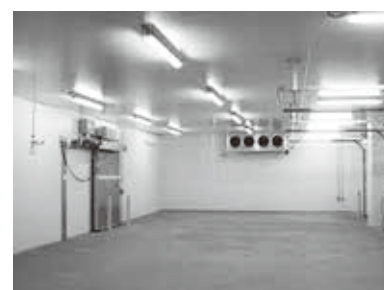
大型貯蔵冷蔵庫(内部)
