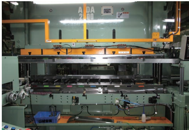
【図1】今回導入した設備
