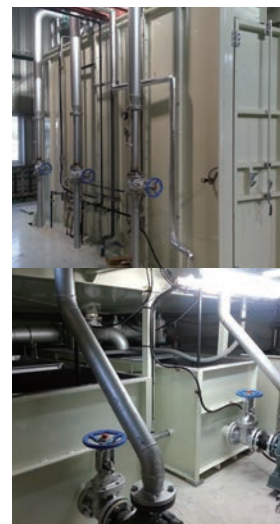
【図2】前処理設備
