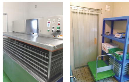
【導入された液体凍結機（左）並びに冷凍冷蔵設備（右）】
