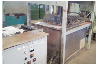
・高速スズメッキ設備
