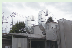
●病院・工場・店舗等の換気設備及びダクト
