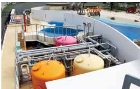
飼育動物を守るための濾過循環設備
