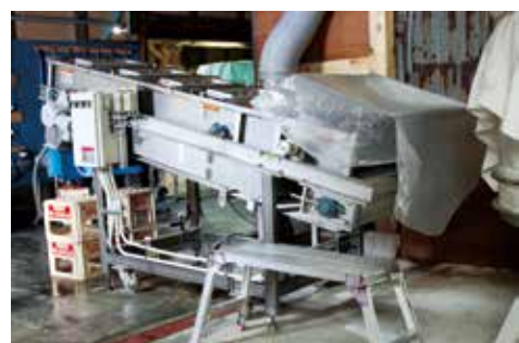
新設の冷却機は作業効率に加え酒質の向上にも貢献
