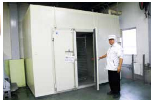
新設された急速凍結庫
