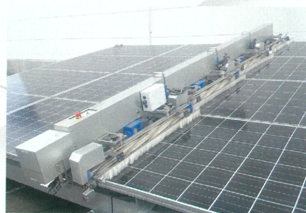
試験中の太陽光パネル清掃装置
