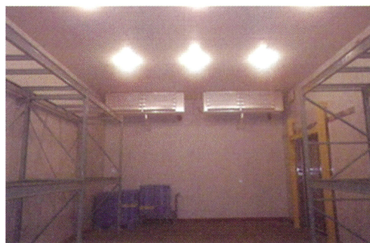
新たに導入した冷凍設備
