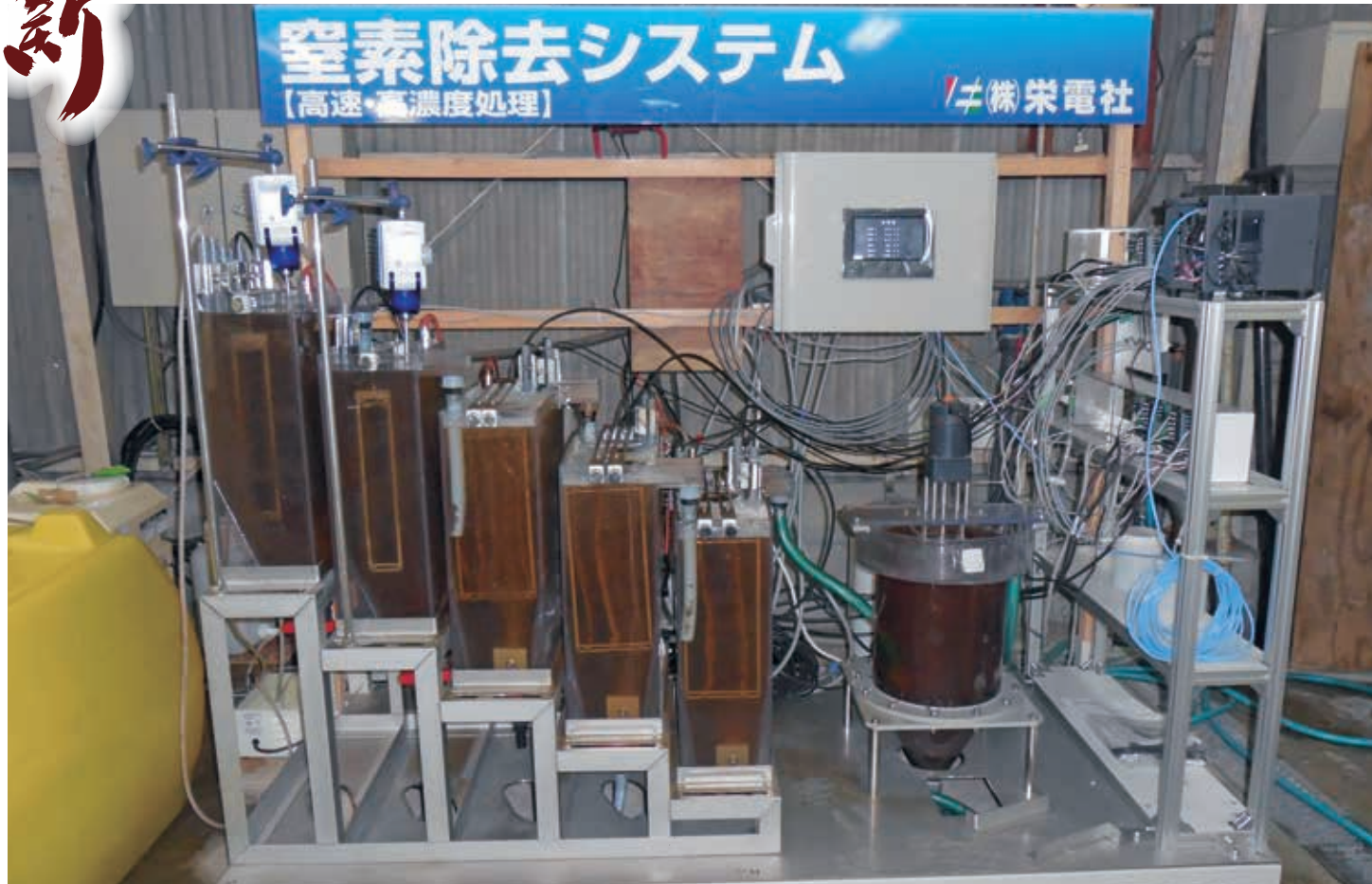
豚フンメタン発酵消化液浄化装置(鹿児島大学内)
