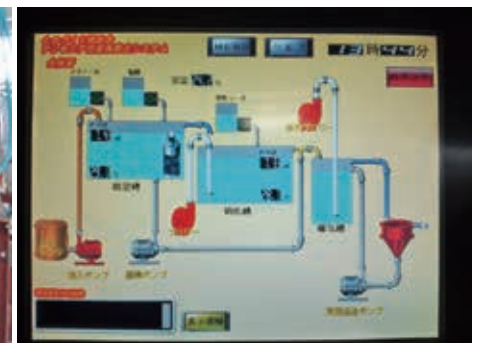
制御盤モニター
