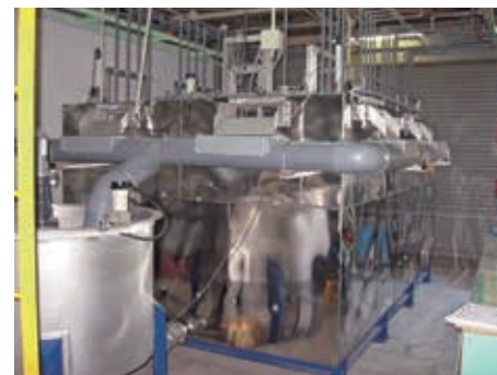
窒素除去装置(半導体工場)
