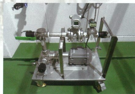
導入した流量計ユニット
