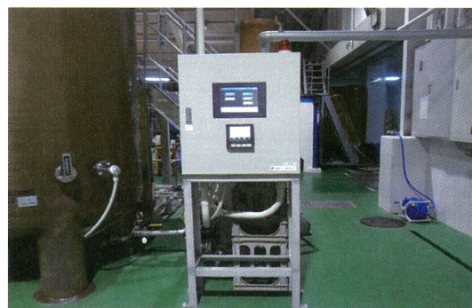
タッチパネルで温度の自動監視
