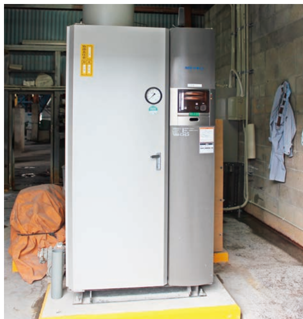
温水を蒸気化する重油ボイラー
