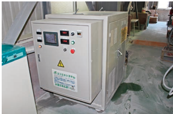
導入したエコエネシステムの本体
