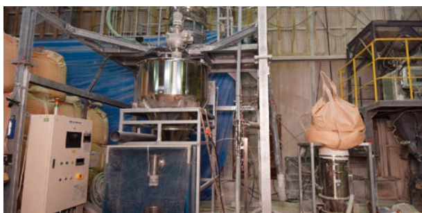
全自動により夜間での作業が可能になった充填計量製造設備一式
