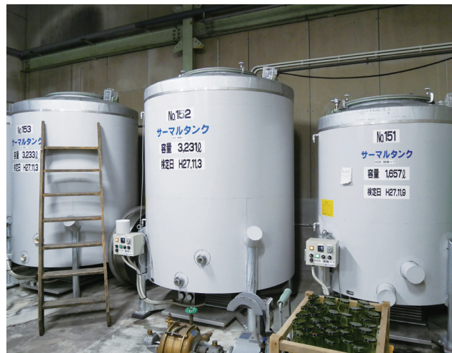
導入したサーマルタンク
