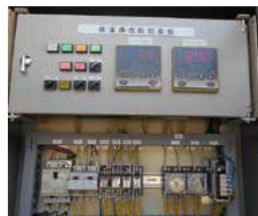
鮮温庫の制御盤
