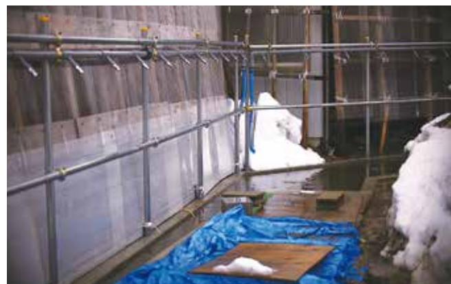
融雪装置の設置状況
