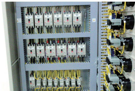
完成した制御盤
