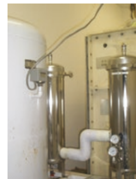
写真1.水濾過システム全体写真
