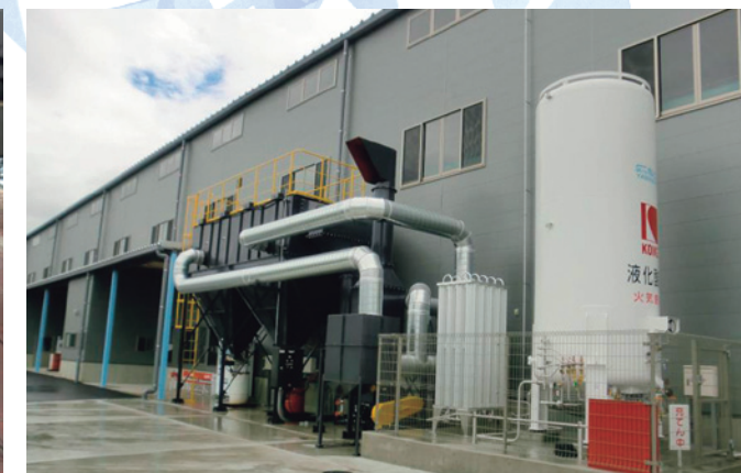
外部に設置した集塵機（ホッパー）
