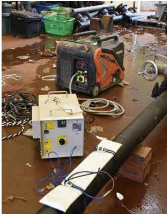
氷結栓を解凍するDOWT装置。コイルが仕込まれた白い部分を水道管に当てて使用する。奥にあるのは発電機
