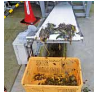
排出コンベアでのゴミ排出
